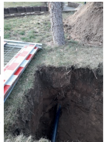
So geht es nicht: Eine mit einem Baum überpflanzte Trinkwasserleitung.
