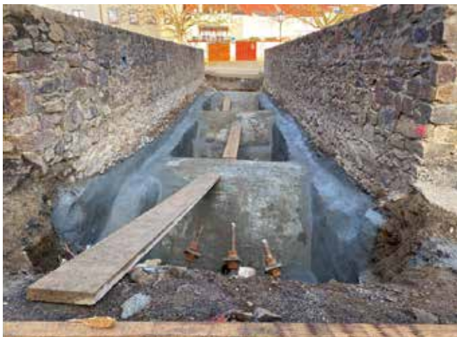
Sanierung der Brücke über den Schlossgraben – Bauphase mit Abdichtung der Gewölb Bögen
