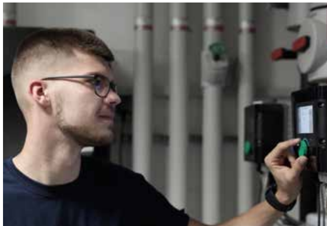
Sie installieren Wärmepumpen, planen Lüftungsanlagen und lassen barrierefreie Badezimmer Wirklichkeit werden. Als Anlagenmechaniker/-in SHK starten junge Frauen und Männer in eine sichere Zukunft. Foto: ZVSHK/txn
