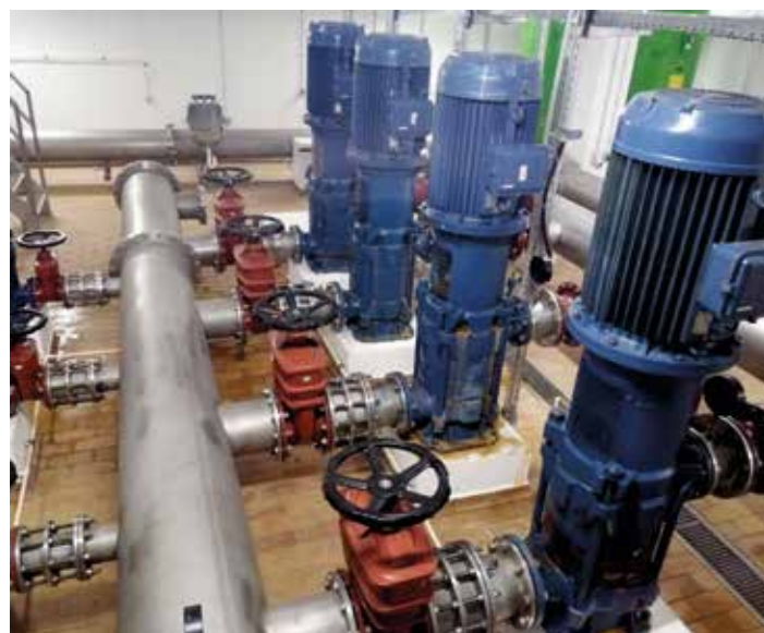
Die Druckerhöhungsanlage Großenhain-West vor dem Umbau.
